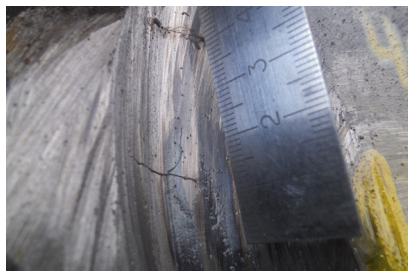
Рис. 5. Трещина выходит на торцевую кромку трубы
