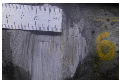
Глубина 6 мм, длина трещины 10 мм
